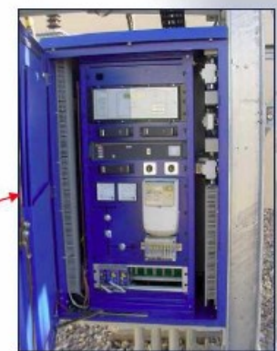
Detalle armario protecciones mando y telecontrol posición
