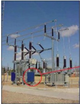
Módulo compacto 145 kV. Pos trafo
