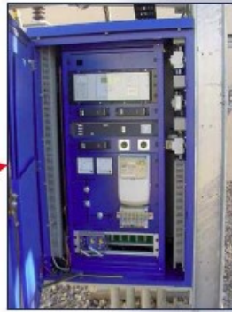
Detalle armario protecciones mando y telecontrol posición
